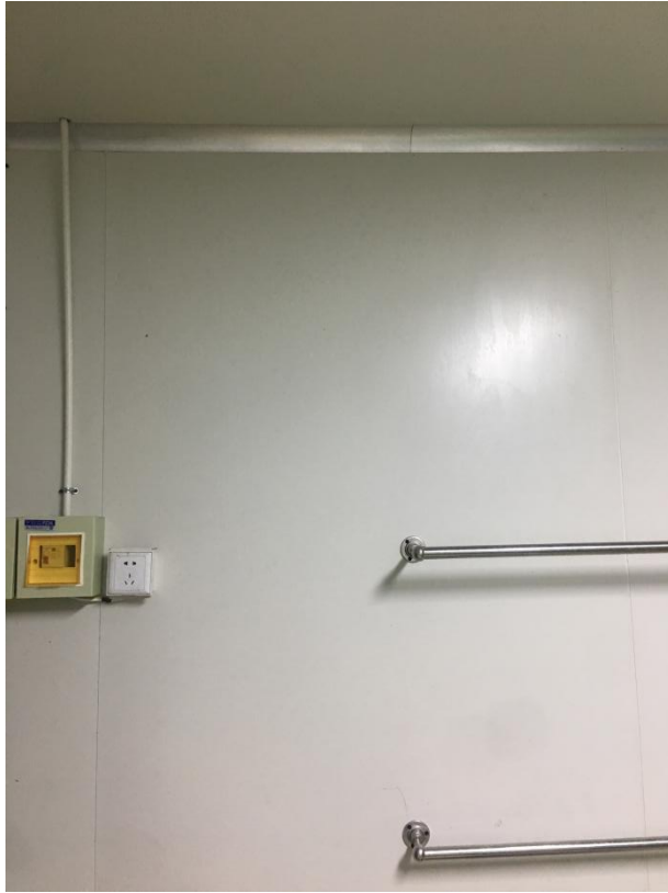
工具清洗间整改前
