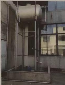
图一 液碱高位储罐
