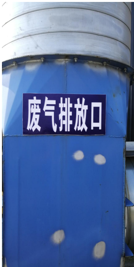
喷漆废气排放口
