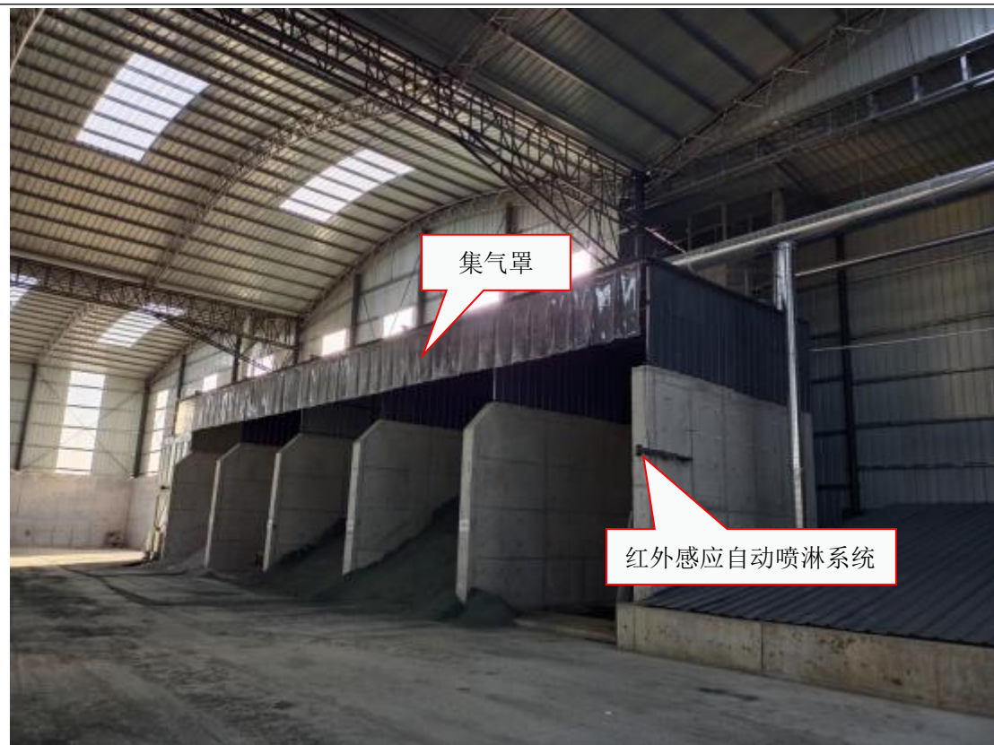
2#搅拌生产线砂石上料集气罩及红外感应自动喷淋系统
