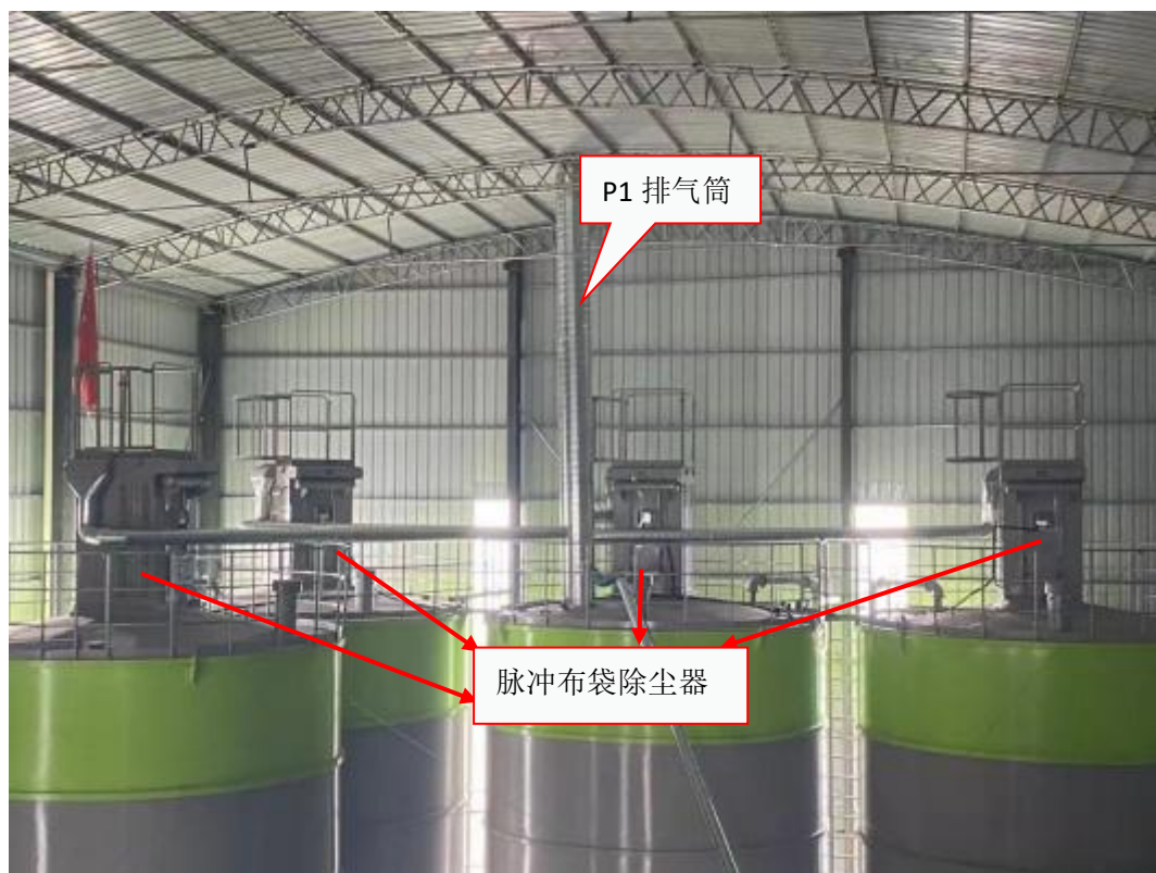
1#搅拌生产线水泥、粉煤灰、矿粉筒仓脉冲布袋除尘器及 P1 排气筒
