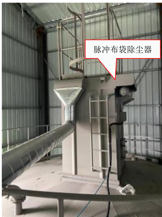
1#搅拌生产线 膨胀剂筒仓脉冲布袋除尘器
