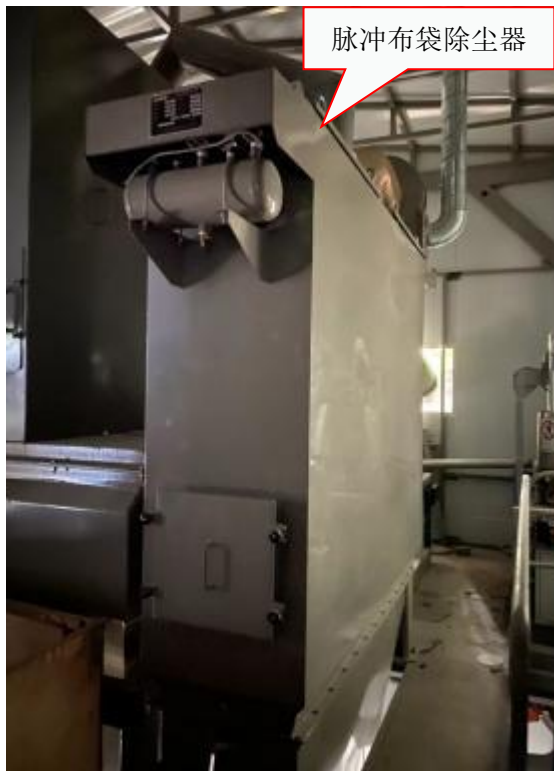
1#搅拌生产线 搅拌主机脉冲布袋除尘器
