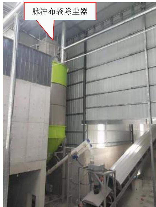
2#搅拌生产线 膨胀剂筒仓脉冲布袋除尘器
