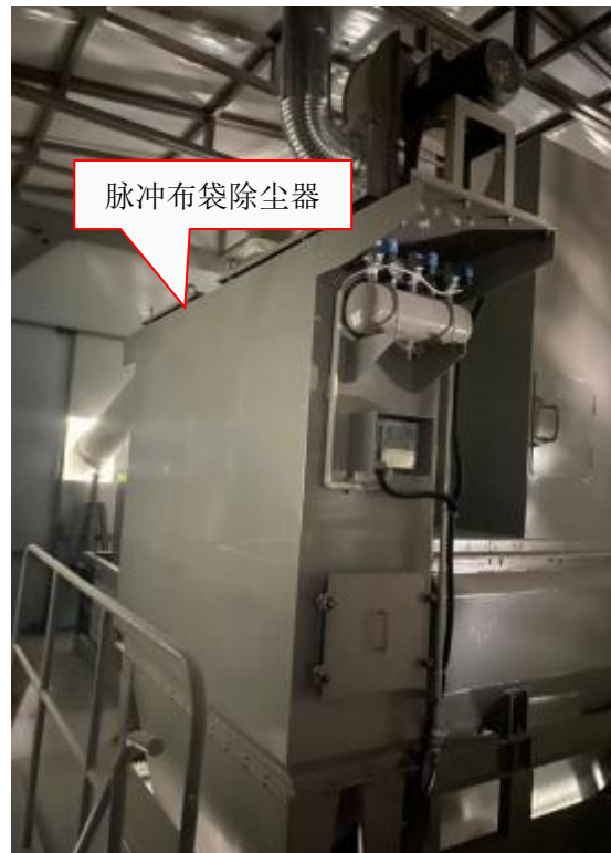
2#搅拌生产线 搅拌主机脉冲布袋除尘器
