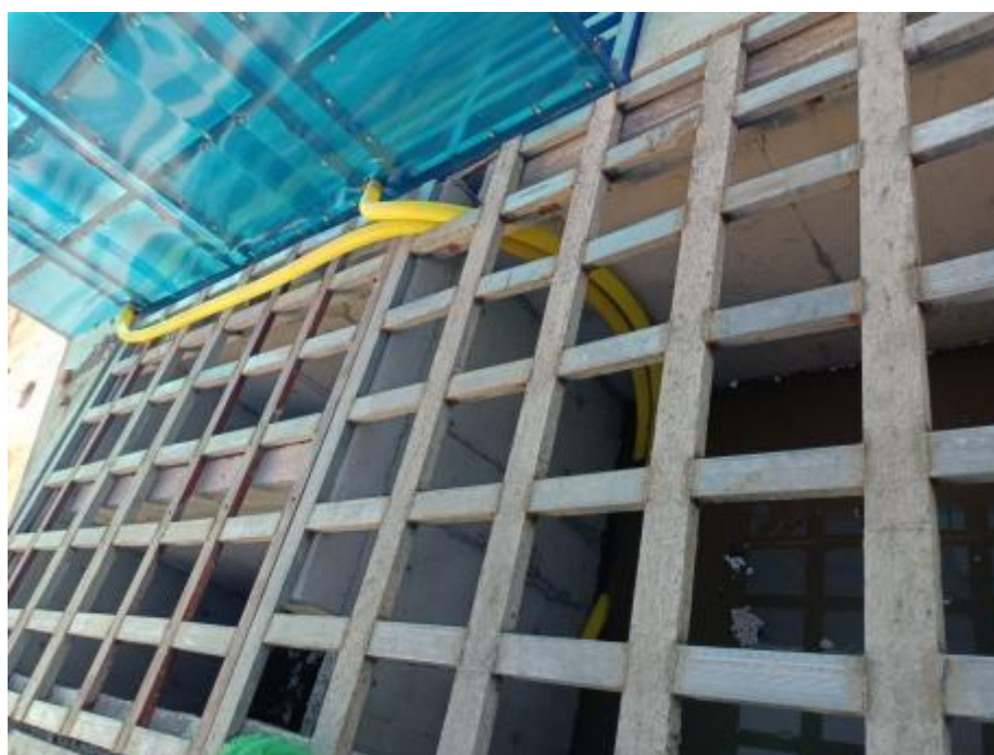
车辆冲洗沉淀池
