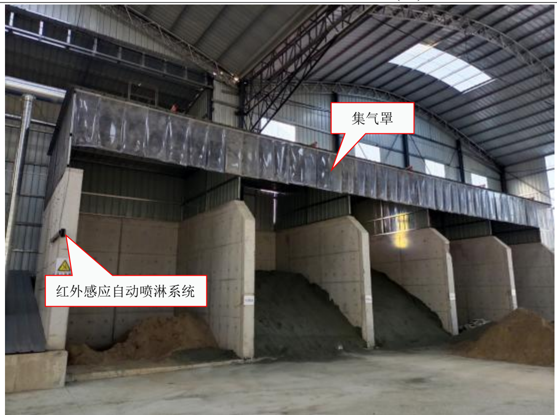
1#搅拌生产线砂石上料集气罩及红外感应自动喷淋系统
