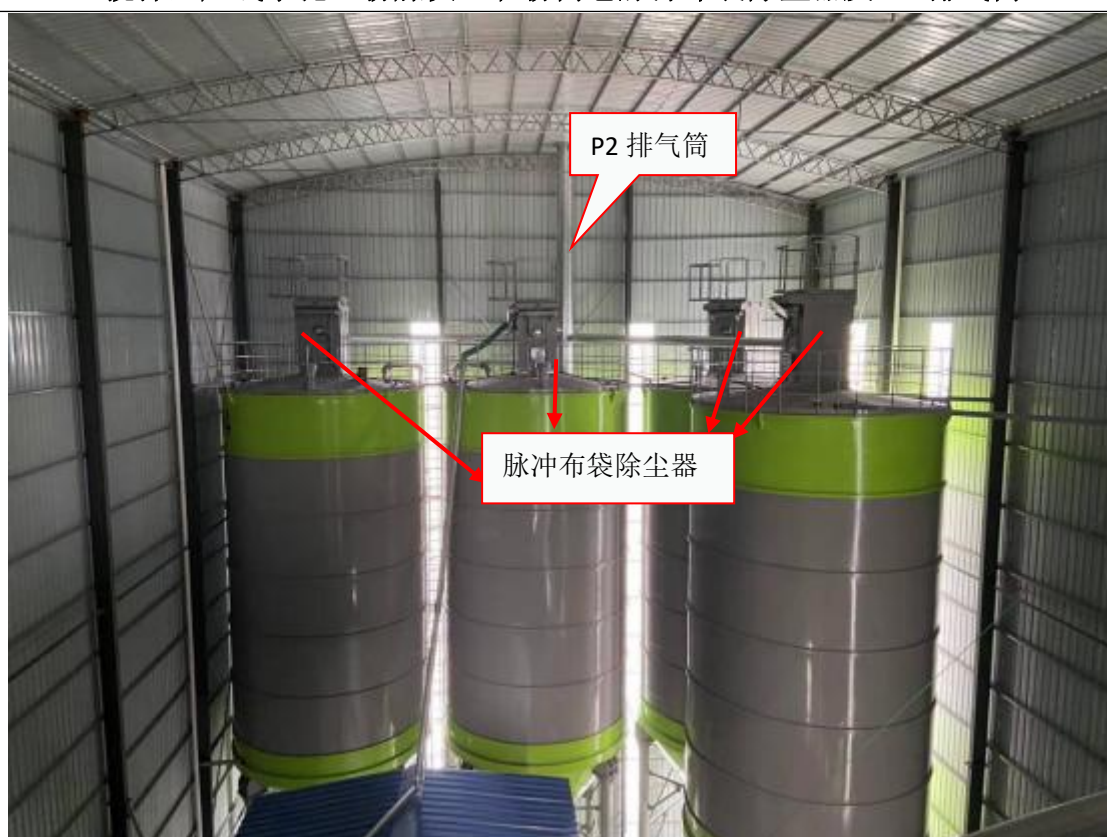
2#搅拌生产线水泥、粉煤灰、矿粉筒仓脉冲布袋除尘器及 P2 排气筒
