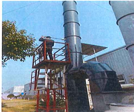
有组织废气排放口
