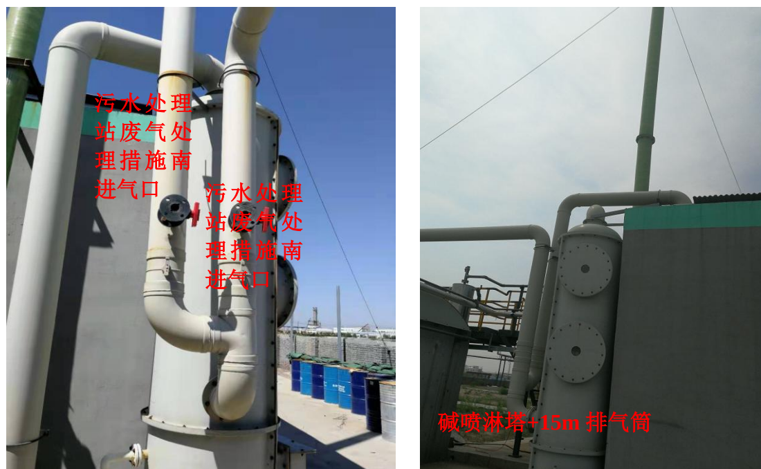
图 4.2-2 P2 排气筒废气处理措施建设情况
