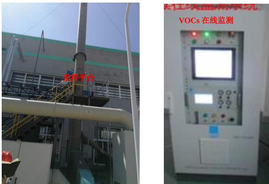
图 4.3-1 1#废气措施采样平台、排气筒、在线监测
