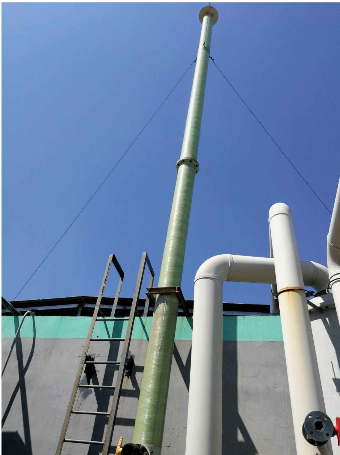
图 4.3-2 2#废气措施排气筒
