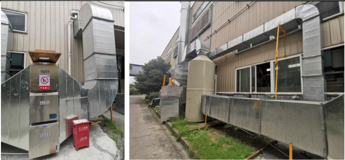
图 2-19 油雾净化器+喷淋塔+两级活性炭吸附箱
