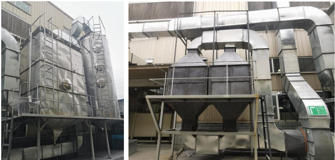
图 2-20 调漆和喷漆废气处理配套的两级喷淋塔+两级活性炭吸附装置
