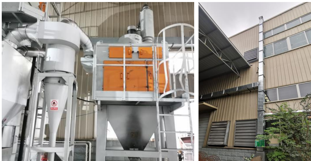
图 2-18 抛丸粉尘旋风+滤筒除尘器+排气筒（DA001）
