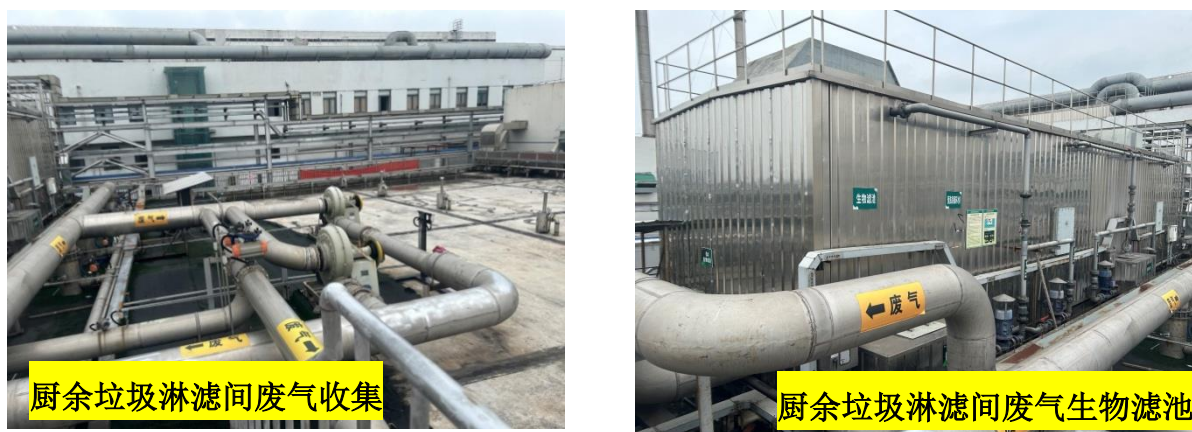
图 4.1-3 厨余垃圾厌氧系统和淋滤系统废气处理设施
