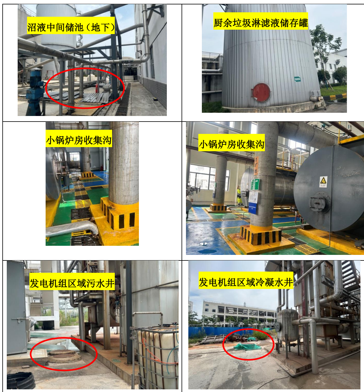
图 4.1-1 厂区废水收集处理设施
