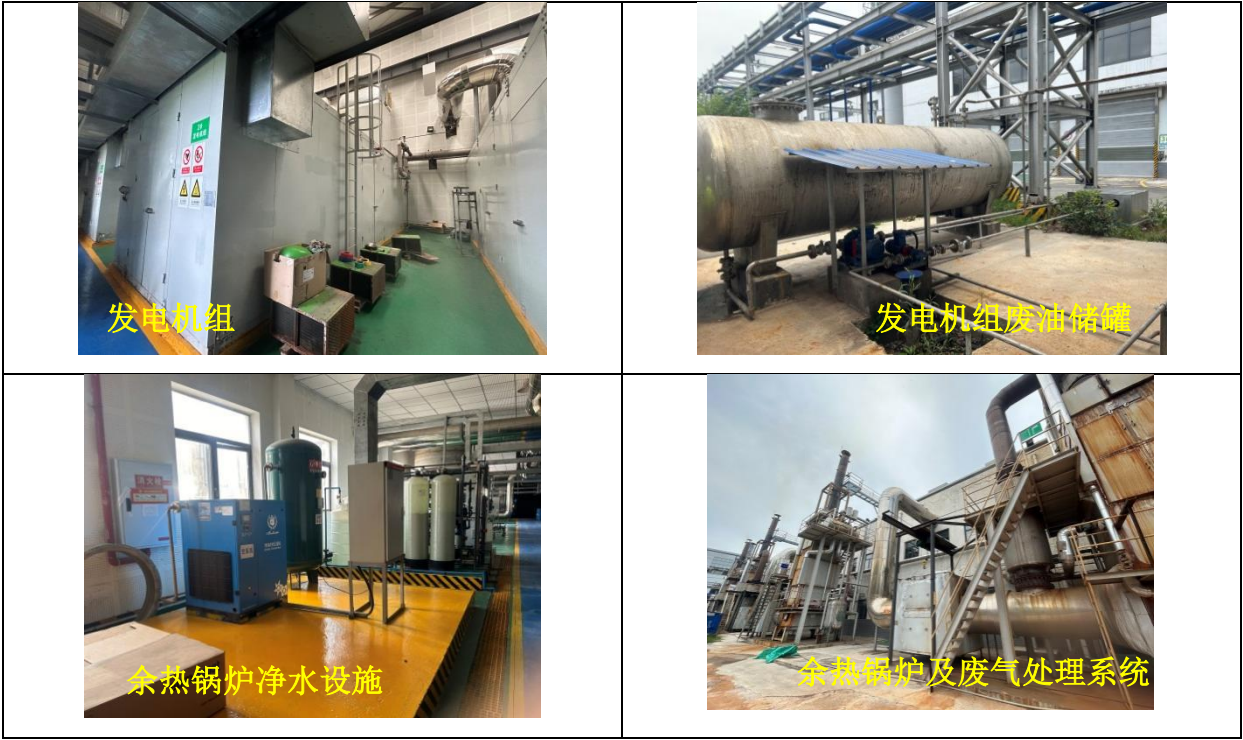
发电机组及余热锅炉系统
