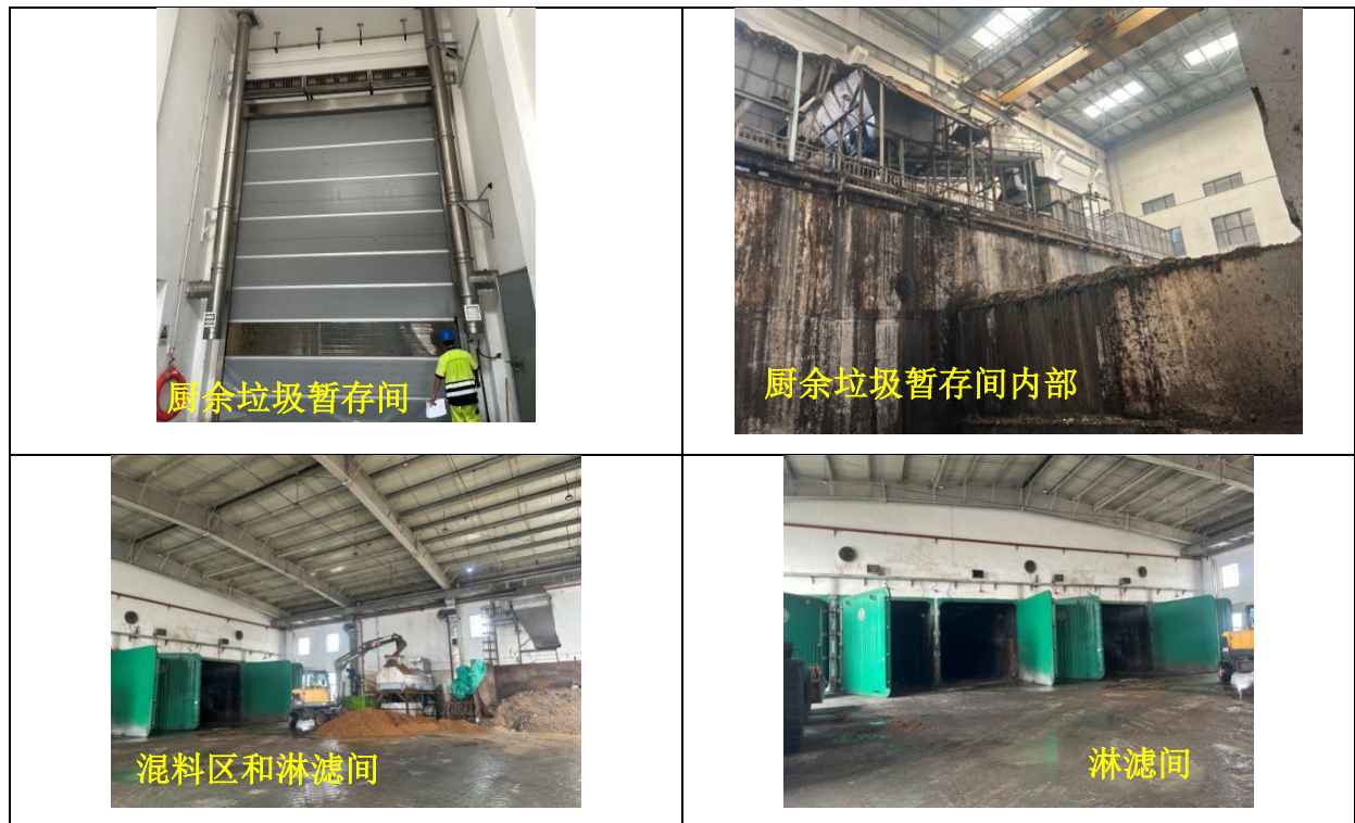
厨余垃圾淋滤及联合厌氧系统
