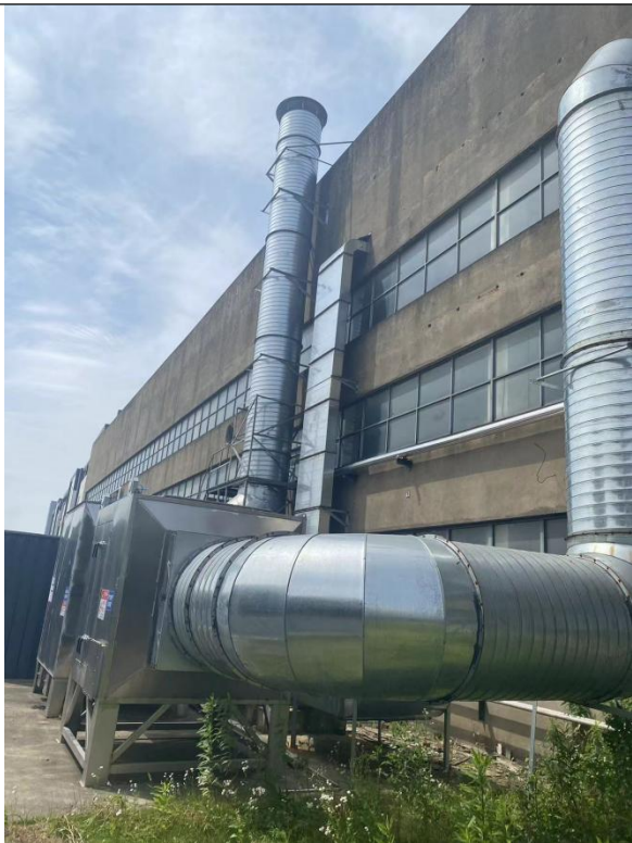
布袋除尘处理废气排放口
