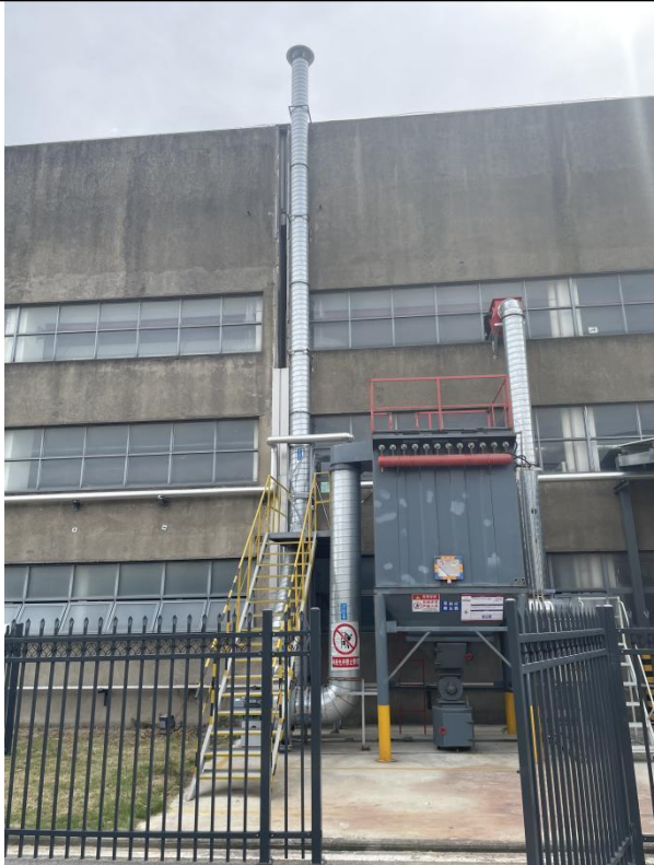
活性炭处理废气排放口
