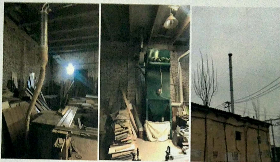
图 3-1 收尘罩+中央除尘器（布袋除尘器）+15m 排气筒现场照片
