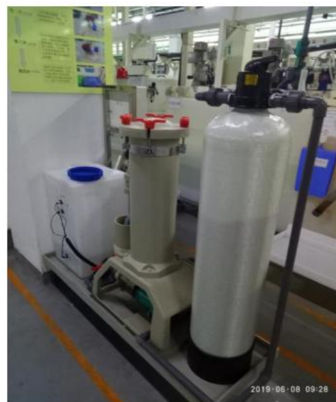
溢流水钯回收设备
