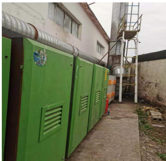
喷漆二车间 UV 光氧+活性炭吸附装置
