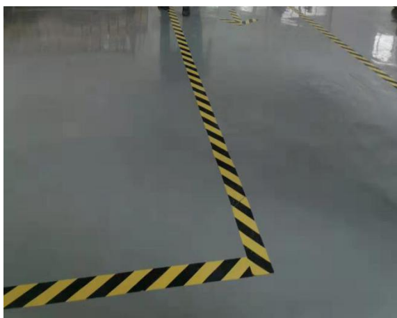
喷漆车间地面防渗措施
