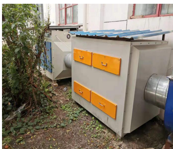
印刷工序 UV 光氧+活性炭吸附装置
