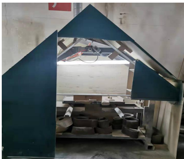
打磨废气收集措施
