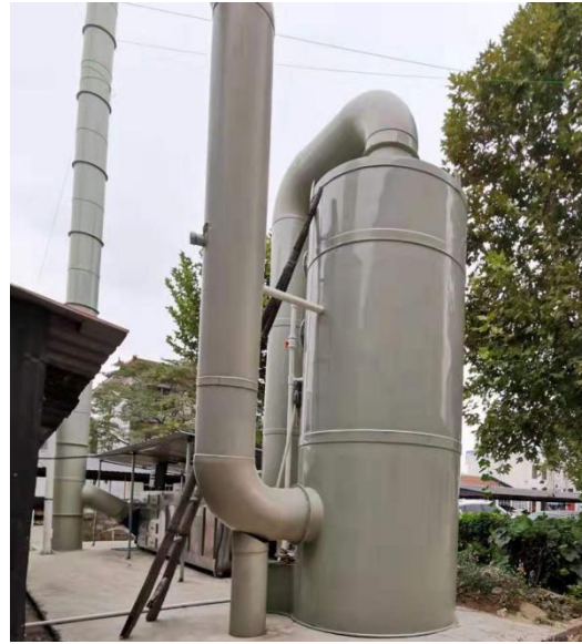
污水处理站废气处理装置
