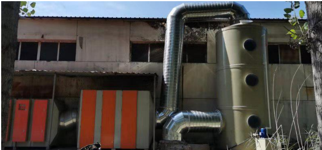
管乐喷漆工序水喷淋塔+过滤箱+UV 光氧+活性炭吸附装置
