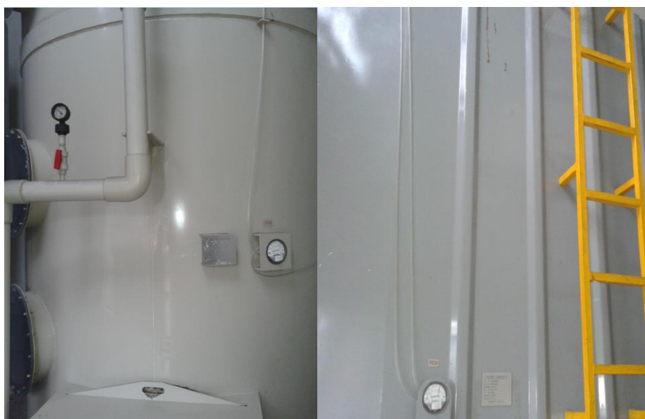
水喷淋吸收塔
