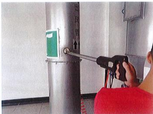
麦芽去石粉尘出口◎4#有组织排放废气检测点位
