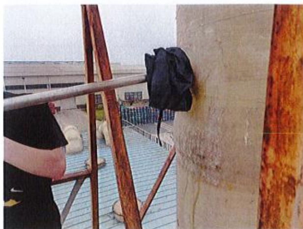
污水处理站生物除臭装置◎10#有组织排放废气检测点位
