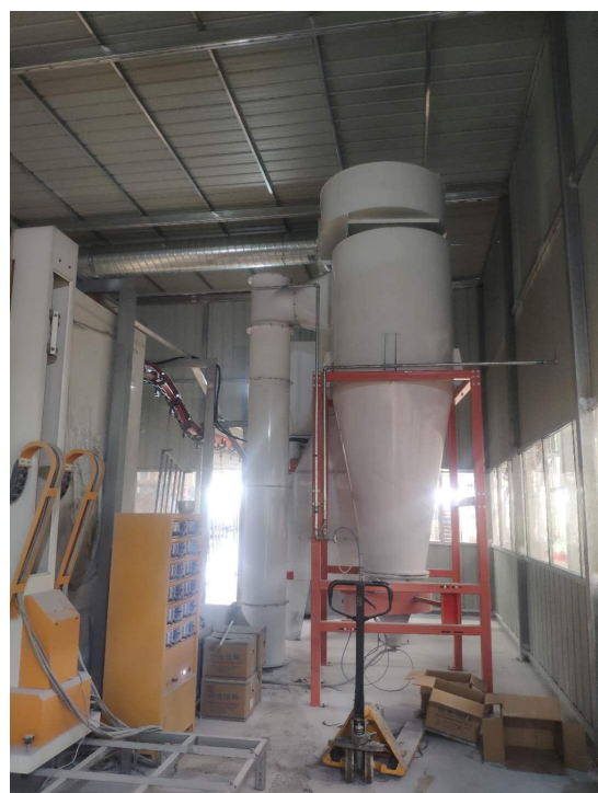
喷涂工序大旋风+高效滤芯除尘器
