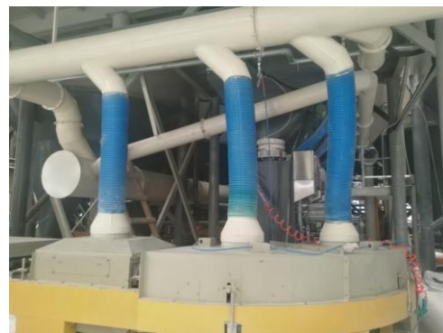
分装工序收集管道
