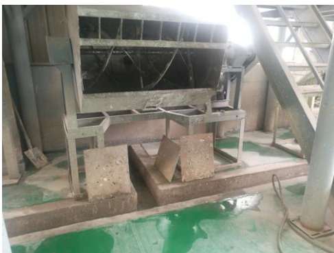
调色区集水沟
