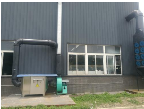
有机废气处理设施
