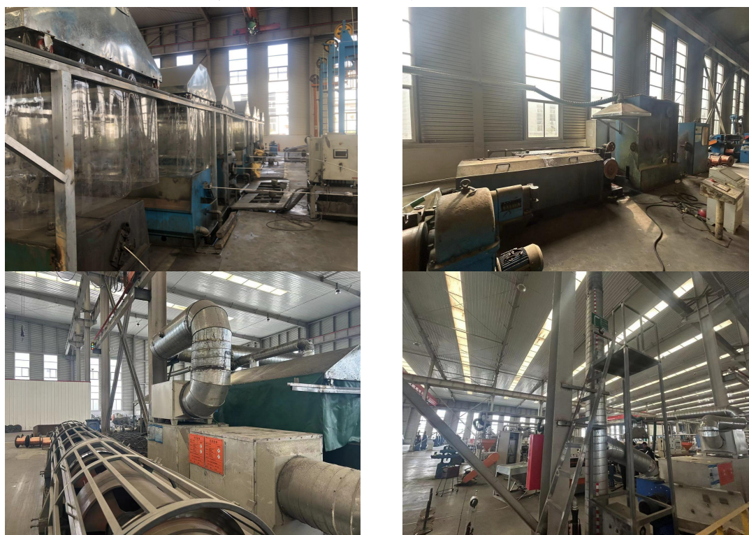
拉丝工序废气治理设施
