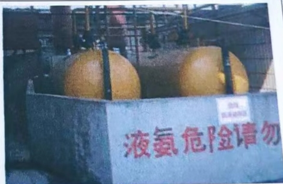
图8-2 液氨高压贮液桶围堰
