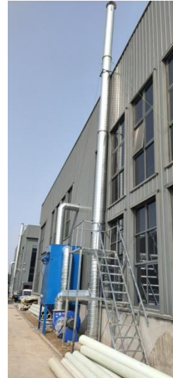
图 4-1 抛光工序、磨床工序、修整工序和电除雾器生产打磨工序排气筒
