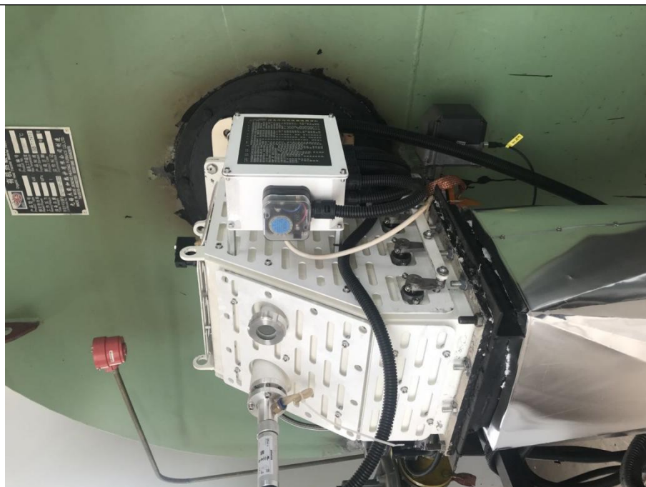
图 5-6 本项目已安装低氮燃烧装置
