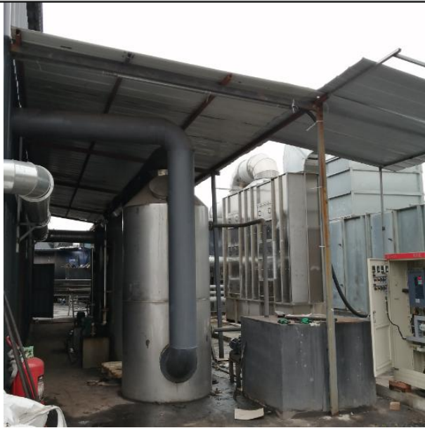
本项目原有废气处理设备：喷淋洗涤+干式过滤+活性炭吸附装置
