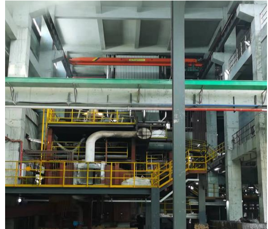
富氧侧吹炉系统
