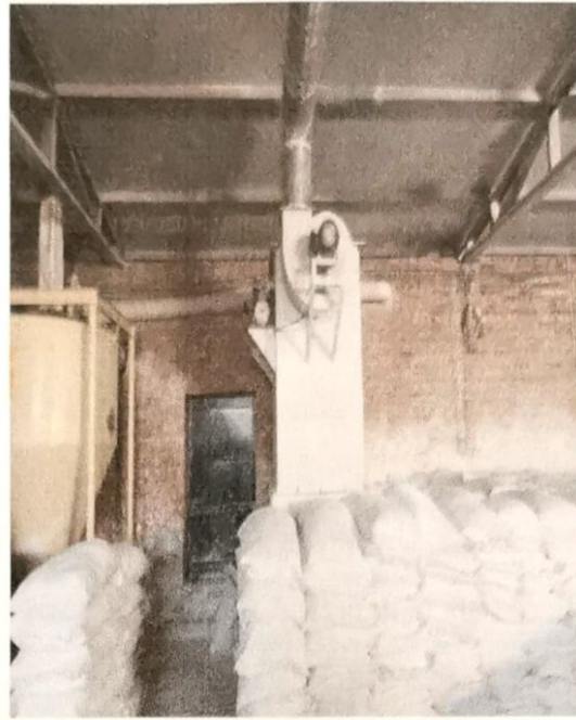
南侧干粉混合机集气罩+脉冲布袋除尘器
