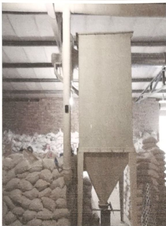
北侧干粉混合机集气罩+脉冲布袋除尘器
