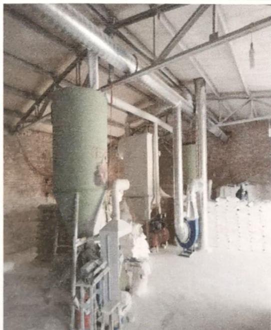
中侧干粉混合机集气罩+脉冲布袋除尘器
