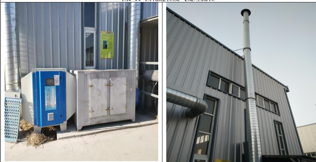
图 3-12 固化工序、天然气燃烧机废气处理设施
