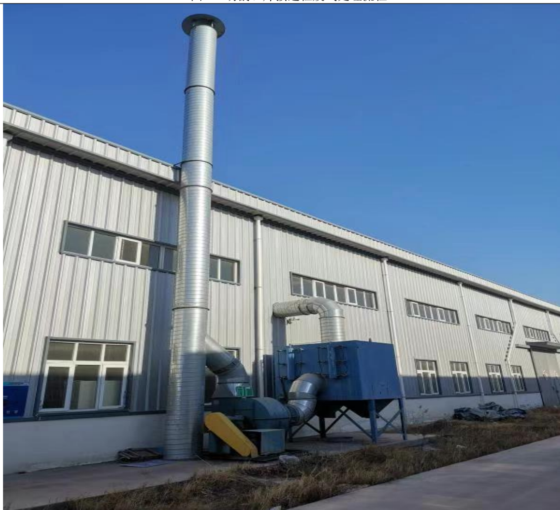
图 3-7 切割、焊接废气处理设施
