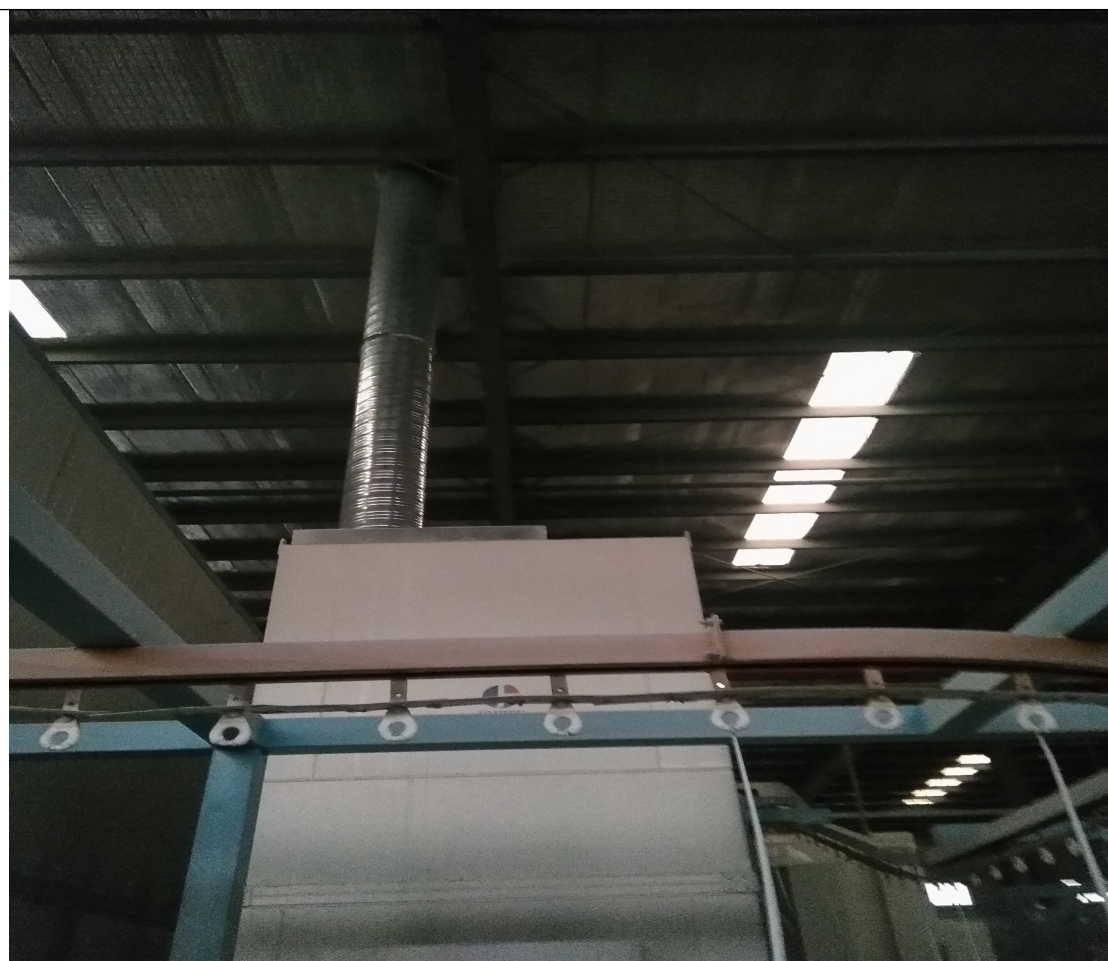
图 3-10 喷塑废气处理设施
