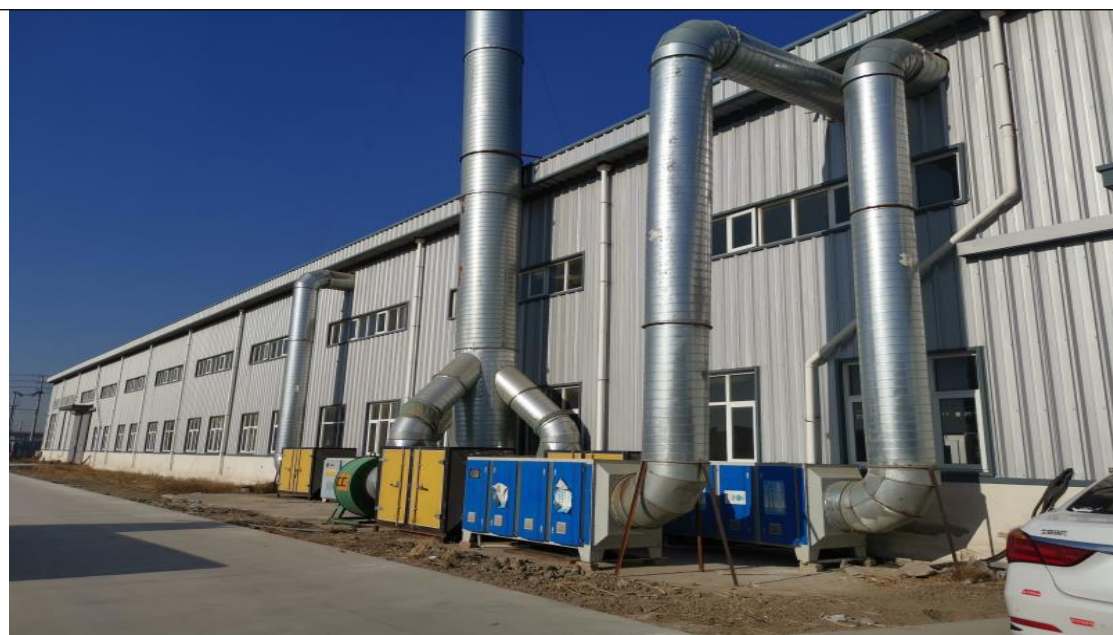
图 3-4 涂胶压板封边、喷漆、晾干、修色废气处理设施
